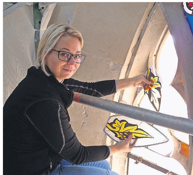
Glasrestauratorin Aline Dold hoch oben auf dem Gerüst mit zwei neuen Scheiben. (Bilder Marianne Voss)
